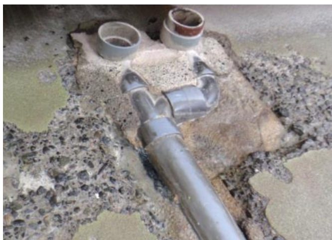
コンクリートが クラック・欠損している
